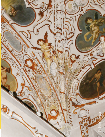
Wasserschaden in der Kreuzkapelle
