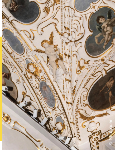
Restaurierter Teil der Kreuzkapelle nach dem Wasserschaden
